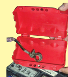
12 Volt DC Starter Batteries
